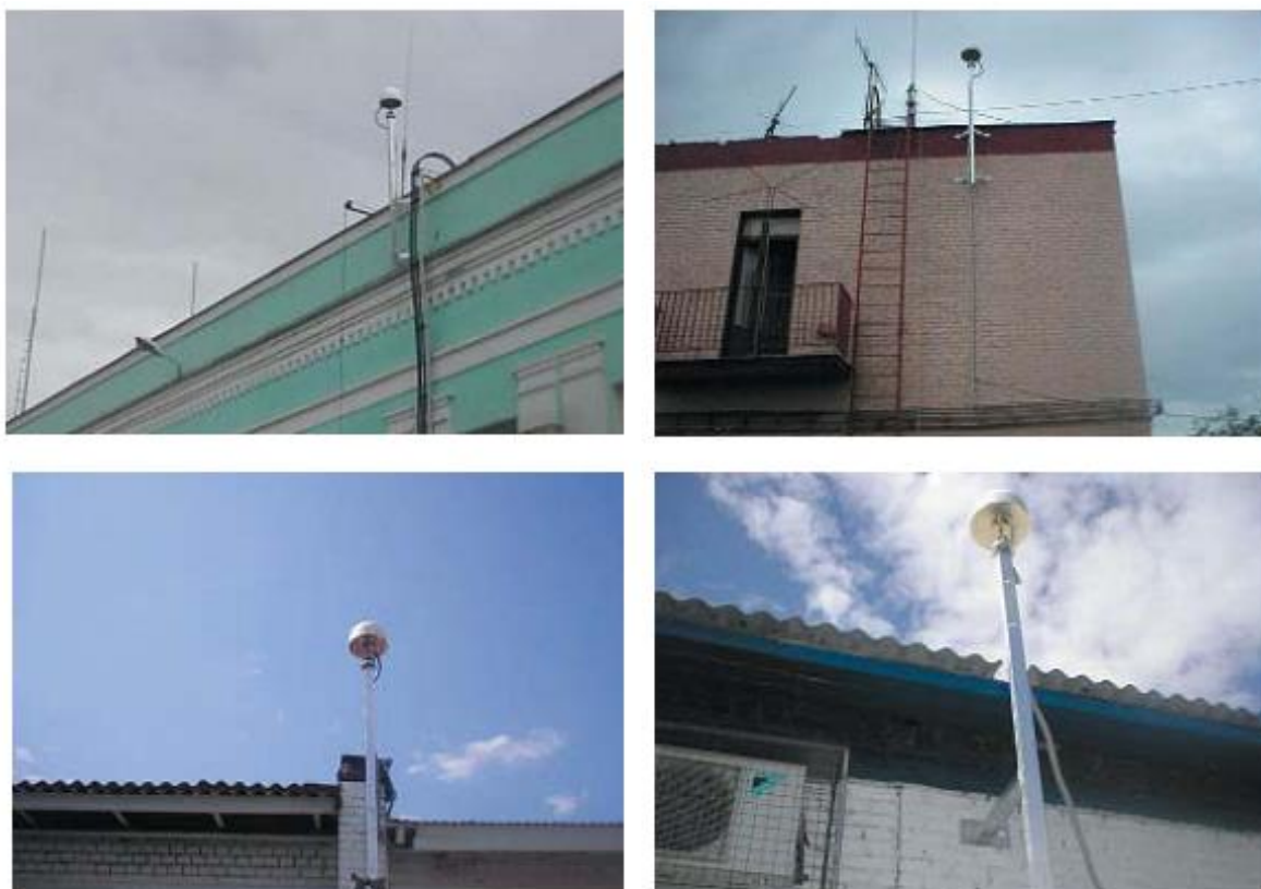
Рис.2. Базовые станции специальной реперной сети на здании поста ЭЦ
